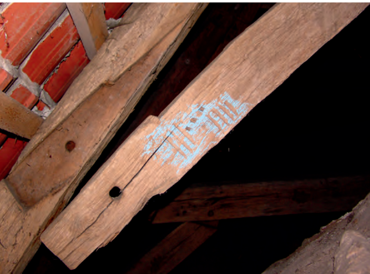
4 Bardowick, Ldkr. Lüneburg, Nikolaikapelle: beschädigter Knotenpunkt mit doppelten Abbundzeichen.
