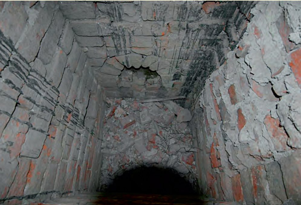
2 Pilsum, Ldkr. Aurich, südöstlicher Eckraum im Vierungsturm, der fast bis zum Bogenkämpfer der Zugangsöffnung voll Schutt gefüllt ist. Die Beobachtungsfenster sind zugemauert worden, ohne dass der Raum von innen betretbar war (siehe Fugenbehandlung rechts im Bild).
