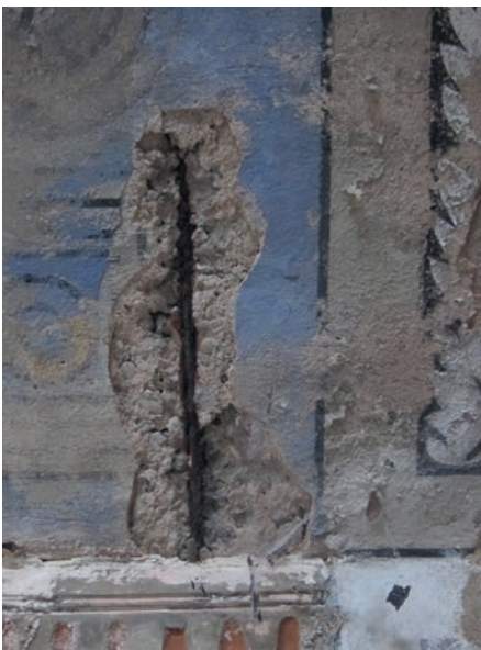
4 Hannover, Südstadt, Stadtfriedhof Engesohde, Mausoleum Völkers, Innenraum, Übergang Wand-Pulldach, Mängel und Schäden an Konstruktion, Fassungsträger und Malerei, Zustand vor der Sanierung.
