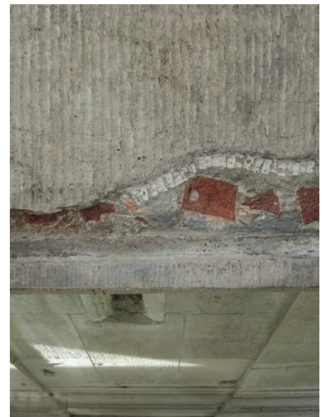
6 Hannover, Südstadt, Stadtfriedhof Engesohde, Mausoleum Völkers, Seitenfassade nach Süd-Osten, Dachrand, historische Dachrinne, Zustand nach Abnahme loser Teile, „grobe“ Kernzone mit Ziegelbrocken und „feine“ Außenzone mit strukturierter Oberfläche.
