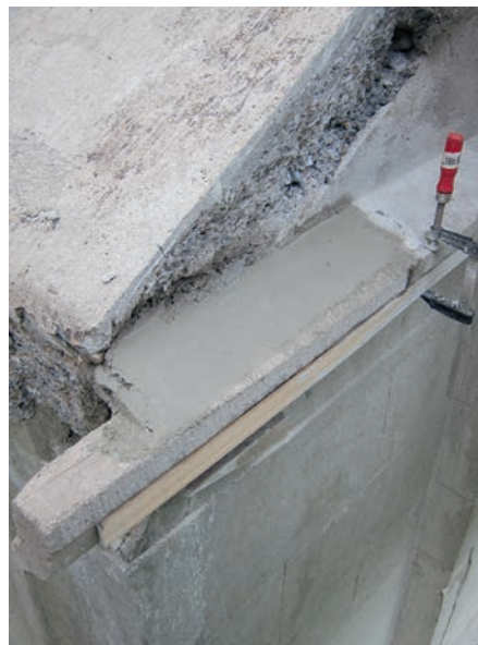
5 Hannover, Südstadt, Stadtfriedhof Engesohde, Mausoleum Völkers, Nord-West-Ecke, Übergang Fassade-Pulldach, Steinerfüllungen, Wiederaufbau Dachrand und Gesimsband.
