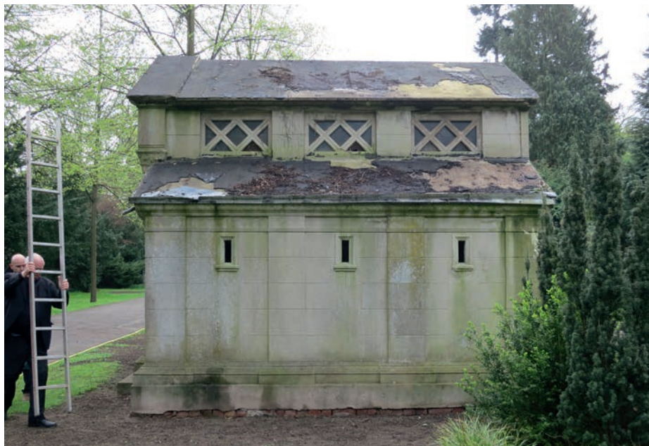
3 Hannover, Südstadt, Stadtfriedhof Engesohde, Mausoleum Völkers, Seitenfassade nach Nord-Westen, abgängige Dachabdichtung, Mängel und Schäden, Zustand vor der Sanierung nach Abnahme des Bewuchses.
