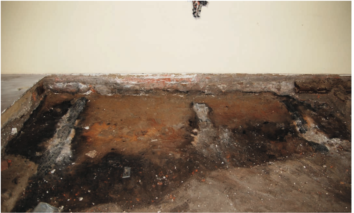
5 Kloster Lüne. Der verbrannte Holzfußboden im Kapitelsaal.
