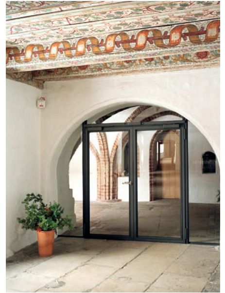
4 Kloster Wienhausen, Rauchabschnittstüren, eingebaut 1999.
