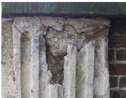
4 Klosterfriedhof Marienwerder, Grabmal von Wehrs, anstuckierter Pilaster vor der Restaurierung.
