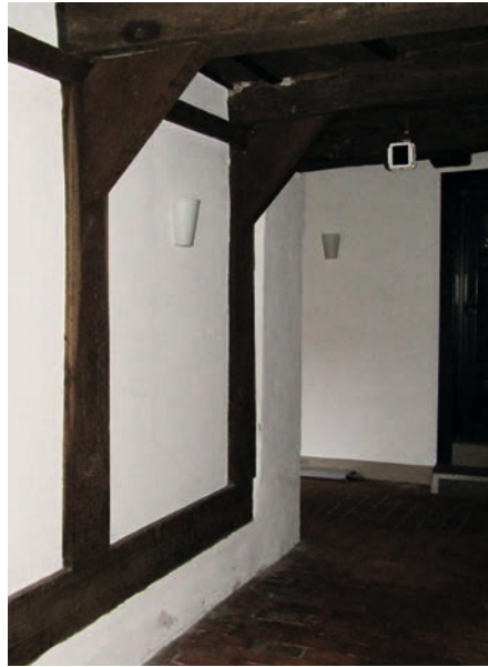
3 Kloster Wienhausen, Gang im Untergeschoss, ausgestattet mit linearem Rauchmelder.
