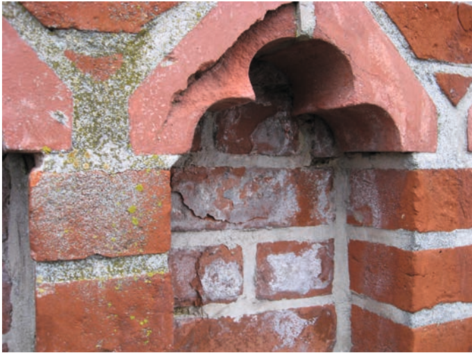
4 Ramelsloh, ehem. Stiftskirche, Schalenbildung durch problematische Hydrophobierung an der Fassade des Westturmes. Zustand 2010.
