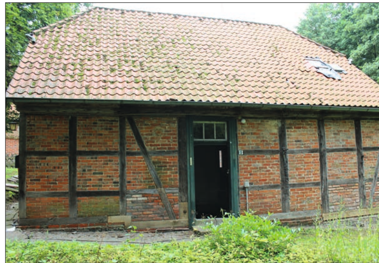
2 Kloster Isenhagen, Gärtnerhaus, Nordfassade 2016 vor der Sanierung. Links ist die zwischen 1841 und 1933 vorgenommene Erweiterung des Hauses um zwei Gefache nach Osten zu erkennen.
