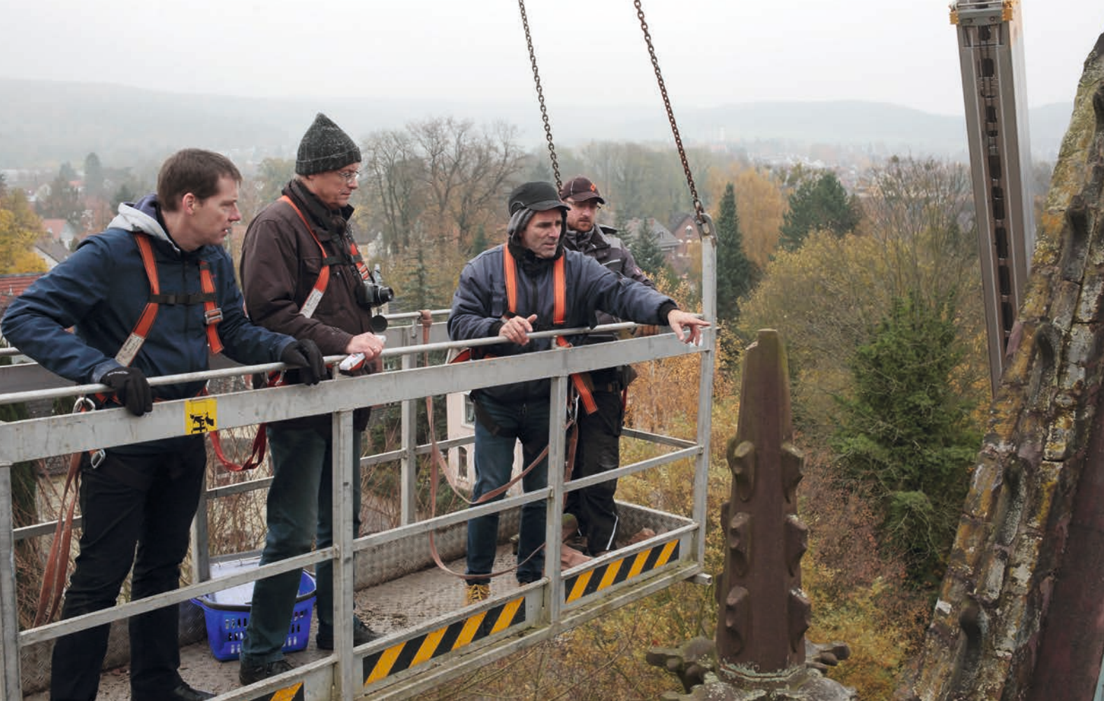
1 Baudezernent Dr. Tim Wameling mit dem Statiker Jürgen Ilsemann und Steinrestaurator Peter Hofmann bei der Schadenserfassung an der Stiftskirche St. Alexandri in Einbeck, November 2017.
